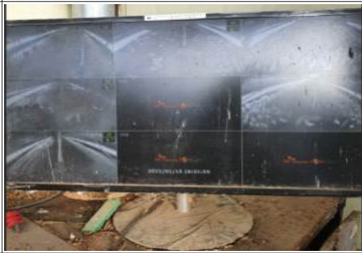
CCTV 고장 방치
